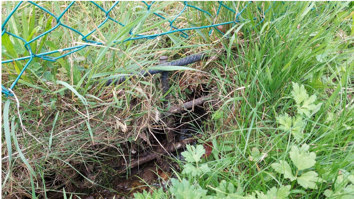
Foto 8: Durchlass Zaun auf offenem, unverbautem Abschnitt Untergass im Bereich Parzelle 793 (GB Kerns) mit verklausungsanfälliger Gitterrost, Blick in Fliessrichtung (oeko-b ag, 15.06.2026).
