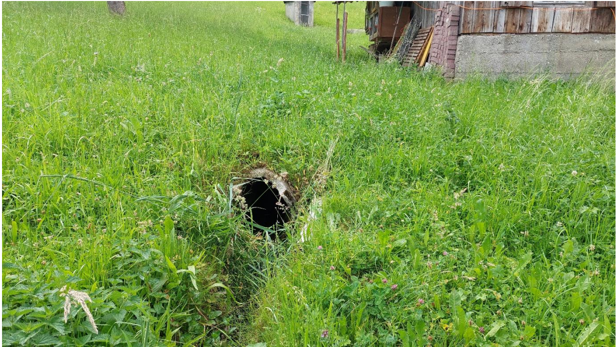
Foto 3: Beginn offener Abschnitt Untergass mit Auslauf aus Betonrohr (dm = 0.4 m), Blick gegen Fliessrichtung (oeko-b ag, 15.06.2026).
