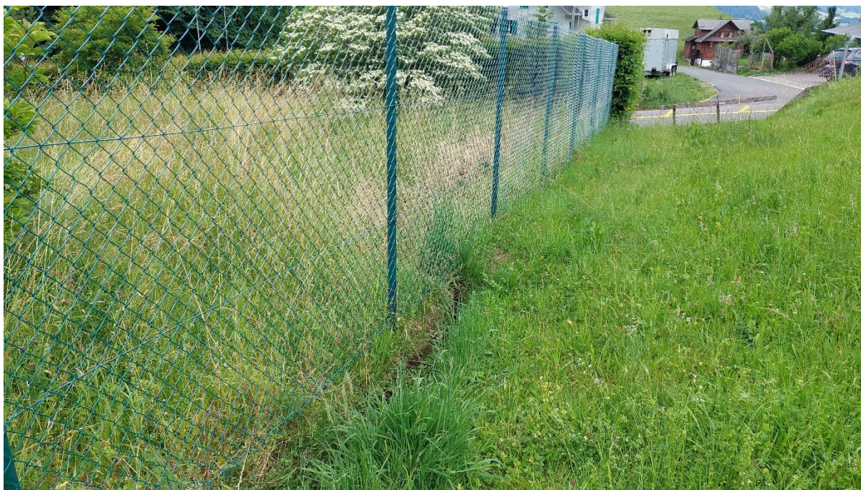
Foto 7: Durchlass Zaun auf offenem, unverbautem Abschnitt Untergass im Bereich Parzelle 793 (GB Kerns), Blick in Fliessrichtung (oeko-b ag, 15.06.2026).
