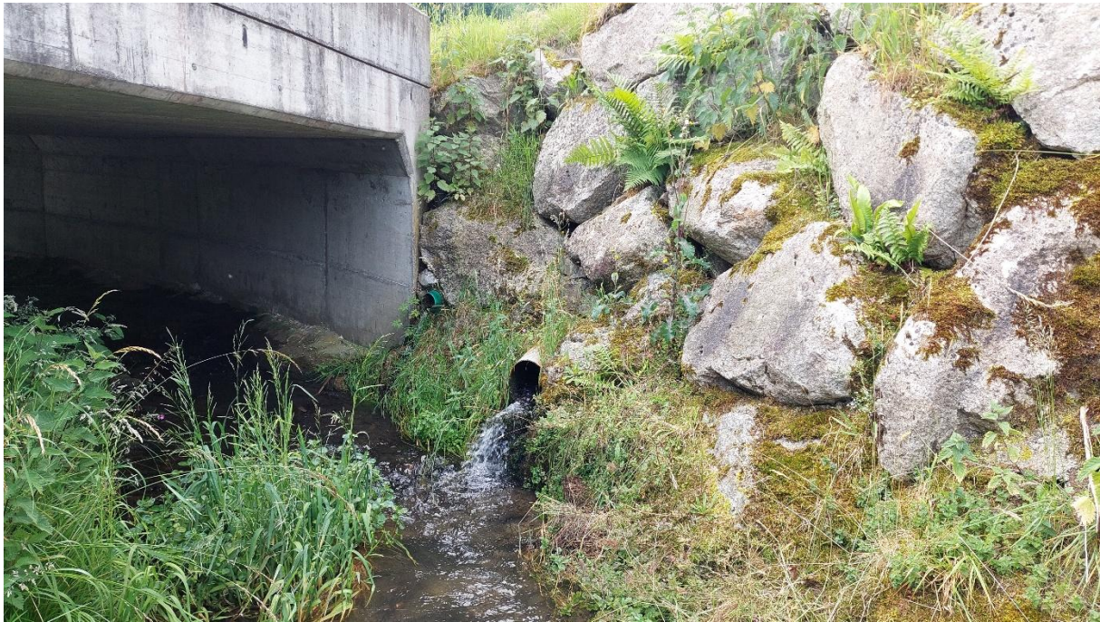
Foto 11: Auslauf Eindolung (PE-Rohr, \text{dm} = 0.25 \text{ m} ) unterhalb Brücke Melchtalerstrasse mit Mündung in den Türligraben (oeko-b ag, 15.06.2026).
